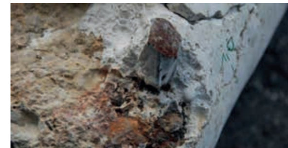
Abb. 2: Korrodierte Anschlussbewehrung im Bereich der Arbeitsfuge einer Winkelstützmauer
